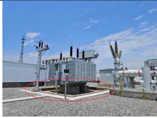
主变事故油坑
