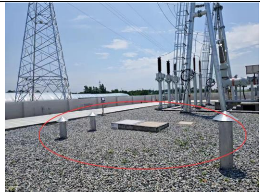
主变事故油池
