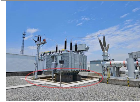
主变事故油坑
