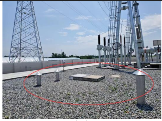
主变事故油池
