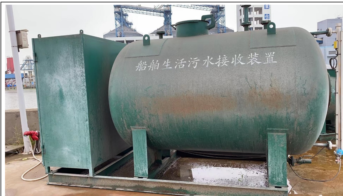
船舶生活污水接收装置
