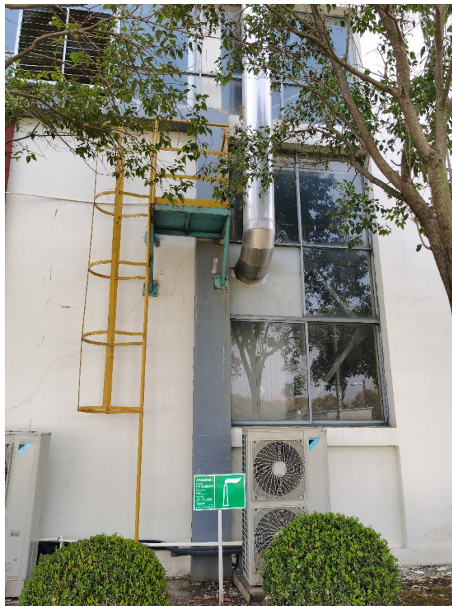
图 3-2 企业废气处理设施实物图
